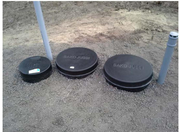
Kuva 5. Kaivonkannet ovat maan tasalla ja tuuletusputket ylettävät lumirajan yläpuolelle. Kuvassa näkyy Biojussi-Mökki 1050 -puhdistamo.
