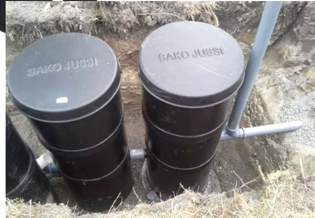
Kuva 2. Biojussi-sakosuodatinkaivo ja Kalkkisuodatinkaivo liitetty yhteen liukumuhvilla. Tuuletusputki on liitetty tuloviemäriin.
