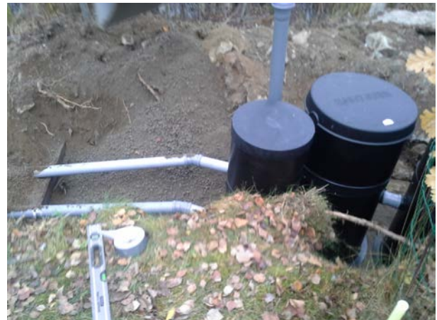
Kuva 3. Kalkkisuodattimesta ja näyteenottokaihosta lähtee 2 putkea purkupaikkaan. Kalkkisuodattimen poistoviemäriputkeen on liitetty tuuletusputki.
