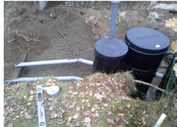
Kuva 3. Kalkkisuodattimesta ja näytteenottokaivosta lähtee 2 putkea purkupaikkaan. Kalkkisuodattimen poistoviemäriputkeen on liitetty tuuletusputki.
