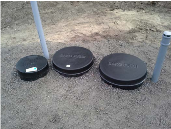
Kuva 5. Kaivonkannet ovat maan tasalla ja tuuletusputket ylettävät lumirajan yläpuolelle.
