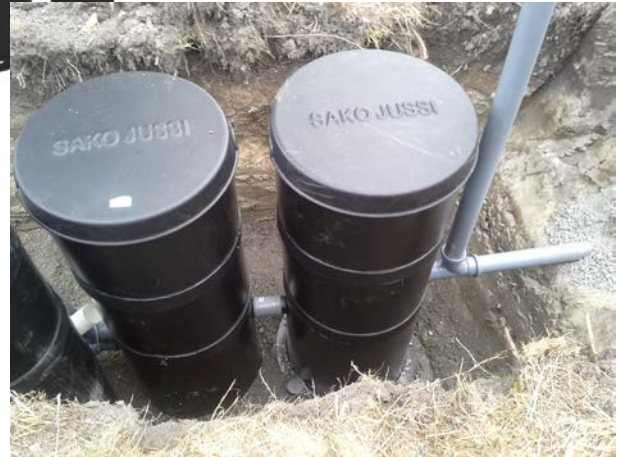
Kuva 2. Biojussi-sakosuodatinkaivo ja Kalkkisuodatinkaivo liitetty yhteen liukumuhvilla. Tuuletusputki on liitetty tuloviemäriin.
