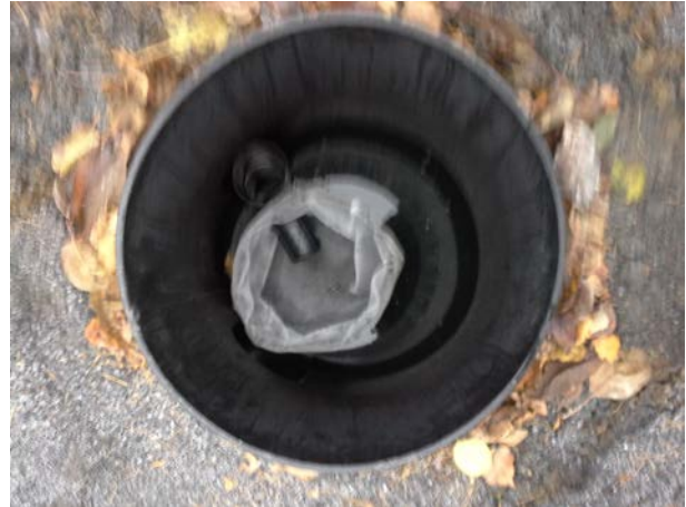
Kuva 5. Vesi virtaa Biojussi-sakosuodatinkaivon suodatinpussin läpi, jolloin suodatinpussiin jää pesuvesien kiintoainetta.
