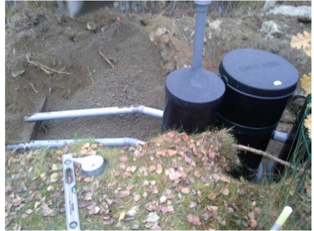
Kuva 3. Kalkkisuodattimesta ja näytteenottokaivosta lähtee 2 putkea purkupaikkaan. Kalkkisuodattimen poistoviemäriputkeen on liitetty tuuletusputki.
