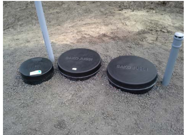
Kuva 6. Kaivonkannet ovat maan tasalla ja tuuletusputket ylettävät lumirajan yläpuolelle.
