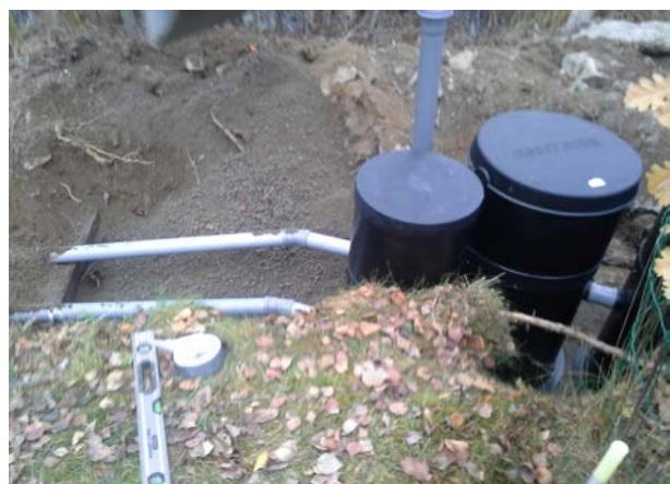
Kuva 4. Kalkkisuodattimesta ja näyteenottokaivosta lähtee 2 putkea purkupaikkaan. Kalkkisuodattimen poistoviemäriputkeen on liitetty tuuletusputki.
